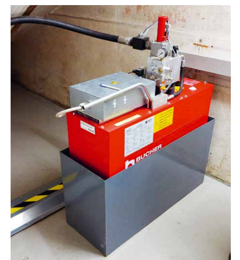
Heizung mit Überschwemmungsschutz.
